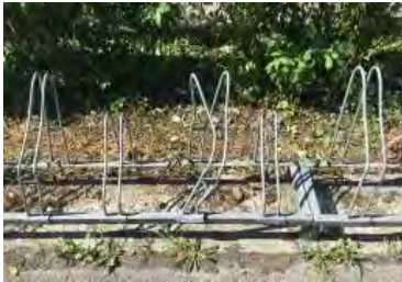
Erneuerungsbedürftige Fahrradständer am Bahnhof (Nordseite)
